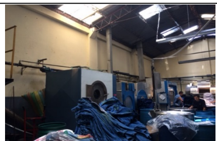
FOTOGRAFÍA 5: SECADORES Y DUCTOS
